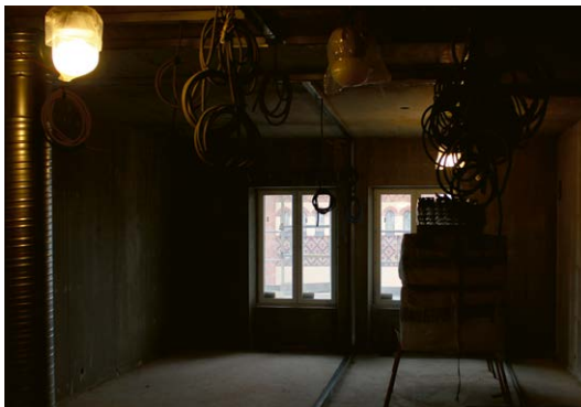
Figur 50. Byggarbetsplats med alltför låg belysningsstyrka.
