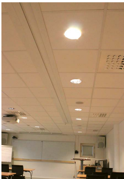
Figur 27. I denna undervisningslokal har armaturer avsedda för montering vid högre takhöjder monterats på 2,4 m höjd. Dessutom valdes en modell med lågt infällningsdjup på grund av begränsat utrymme mellan bjälklag och innertak. Resultatet blev kraftigt bländande ljuspunkter alltför nära de centrala delarna av synfältet. Vid eftermontering av bästa tillgängliga bländskydd minskade bländningen något men är fortfarande besvärande. Exemplet betonar vikten av belysningskompetens hos projektören samt krav på provinstallation som en del i köparens beställarkompetens.
