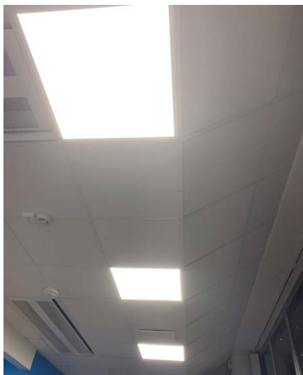
Figur 49. Luminansen hos de infällda LED-armaturerna var här cirka 3 400 cd/m 2 medan det väsentligt mörkare omgivande innertakets luminans var cirka 50 cd/m 2 . Den höga luminanskvoten 70:1 medförde i denna lokal påtagligt besvärande kontrastbländning.
