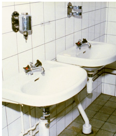
Asbest kan förekomma i kakelfix och fog.
