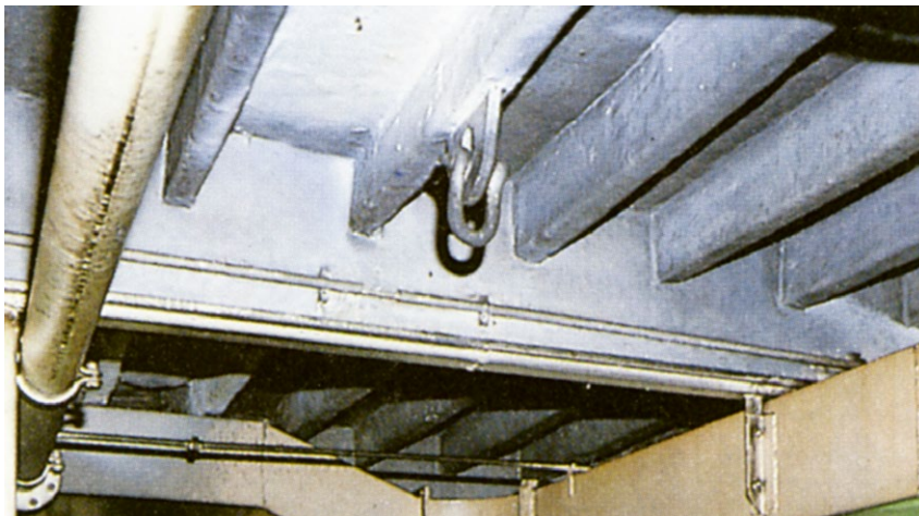
Tak i pannrum, sprutat med asbestisolering.
