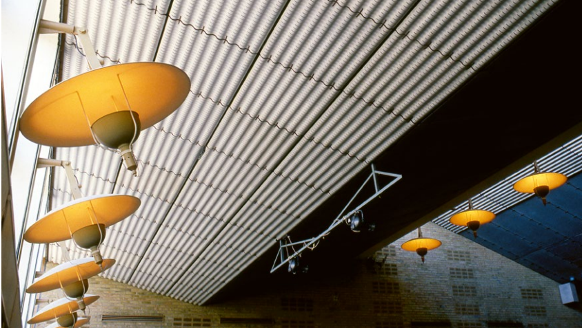
Asbest förekom allmänt som tak- och väggmaterial, här som takmaterial i en skola.
