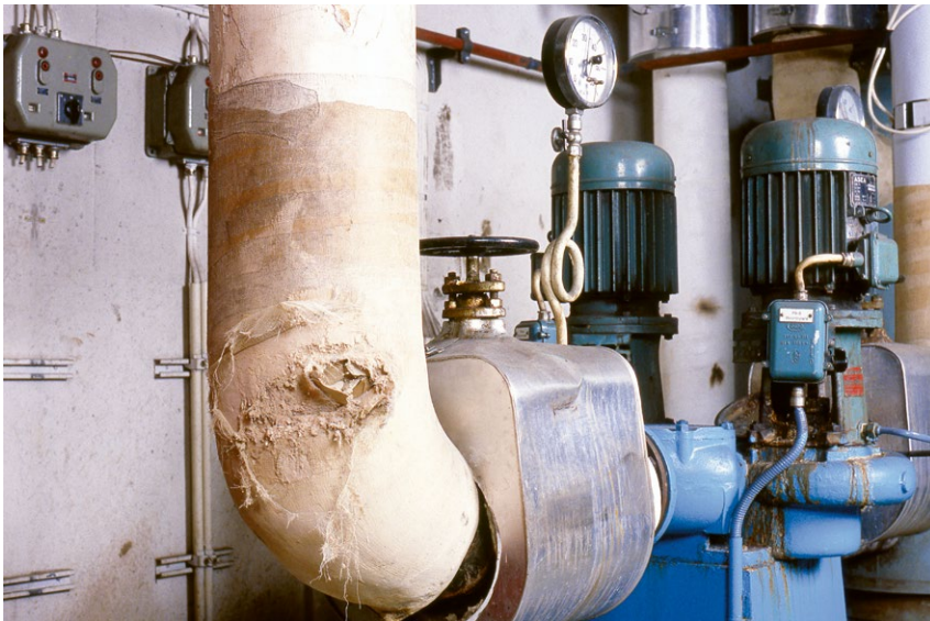
En trasig rörböj medför risk för spridning av asbestdamm och måste omedelbart åtgärdas.
