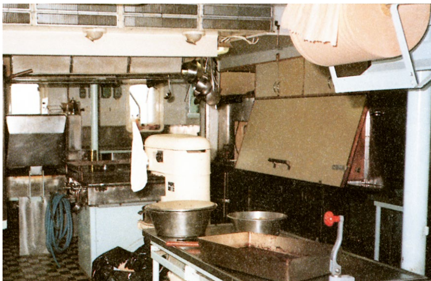
Fixmassan i det här köket innehåller asbest.
