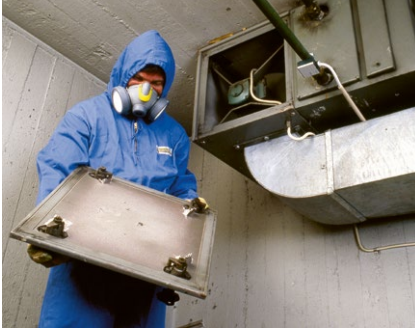
När ett fläktsystem inventeras konstateras asbest på insidan av en lucka.
