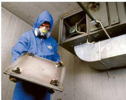
När ett fläktssystem inventeras konstateras asbest på insidan av en lucka.
