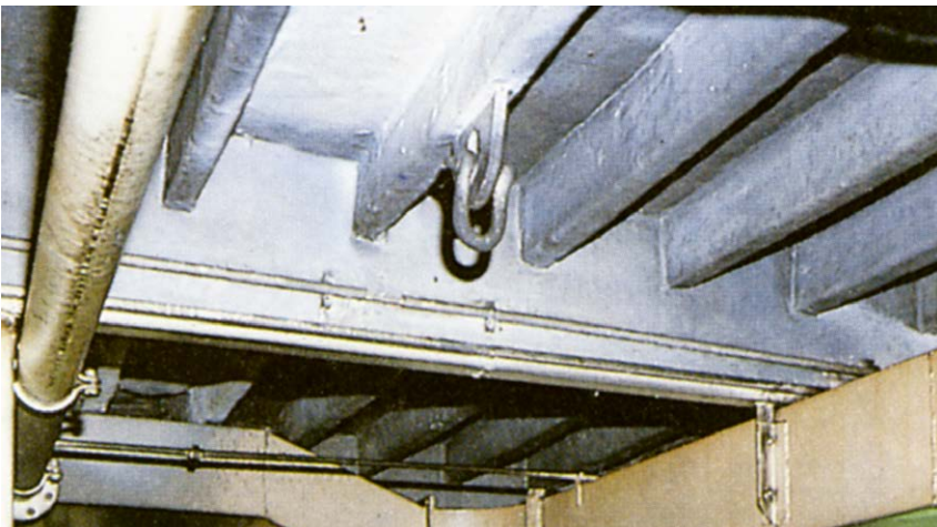
Tak i pannrum, sprutat med asbestisolering.
