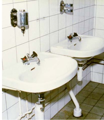
Asbest kan förekomma i kakelfix och fog.
