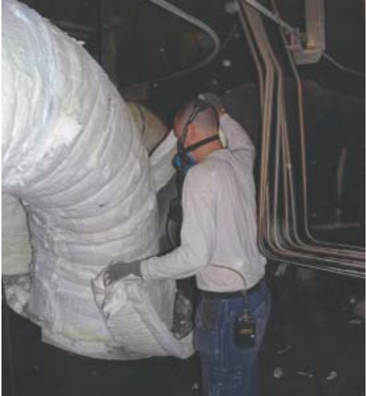
Rivning av isolering på ett värmeverk. De eldfasta fibrerna är av AES-typ (eldfast mineralull).
