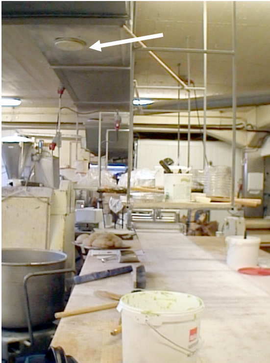
Figur 2, ovan vänster. Omblandande ventilation. Olämplig placering av tilluftsdon i tak ovanför bakbordet. Luften kommer in i lokalen horisontellt genom spalten. Luften över bakbordet stiger mot donet. På vägen upp passerar den dammbemängda luften ansiktet på personer som arbetar vid bakbordet.
