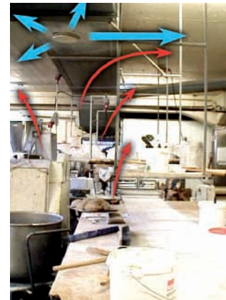
Olycklig placering av tilluftsdon över bakbord
